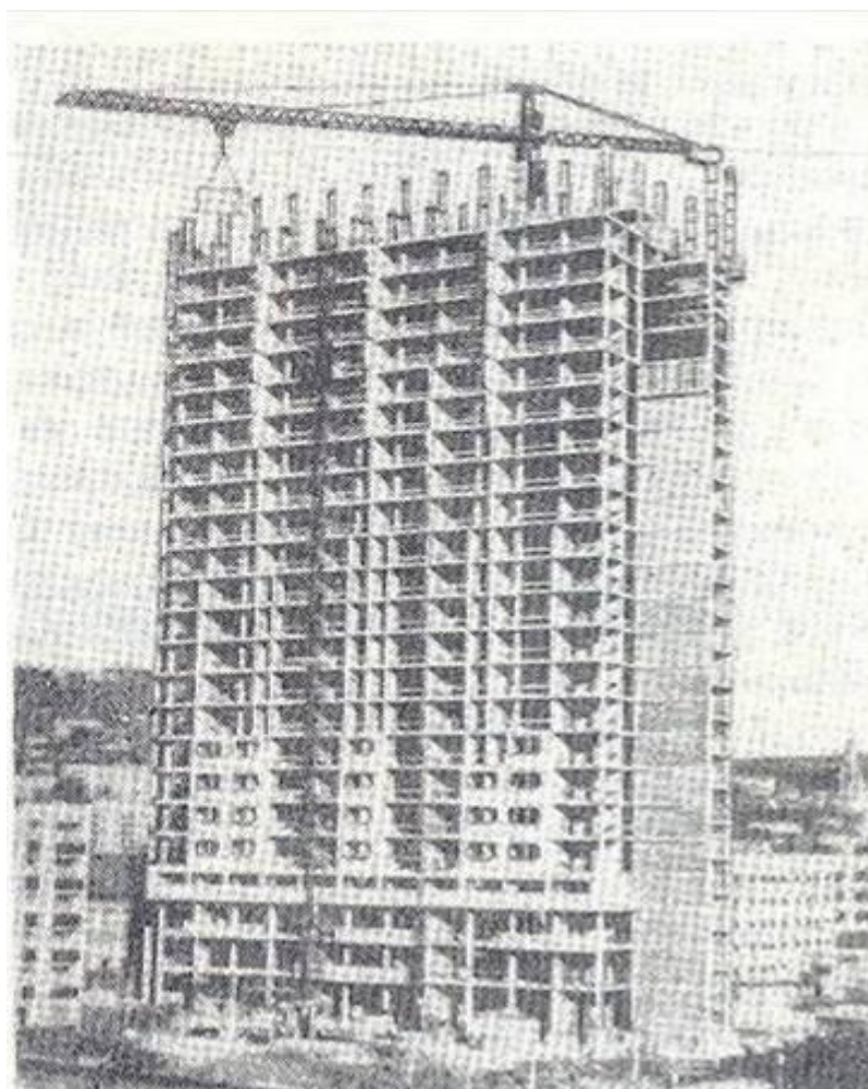
1-сурет. Венгриядағы Пич қаласындағы IMS жүйесі бойынша тұрғызылып жатқан 25 қабатты қаңқалы-панельді тұрғын үй
