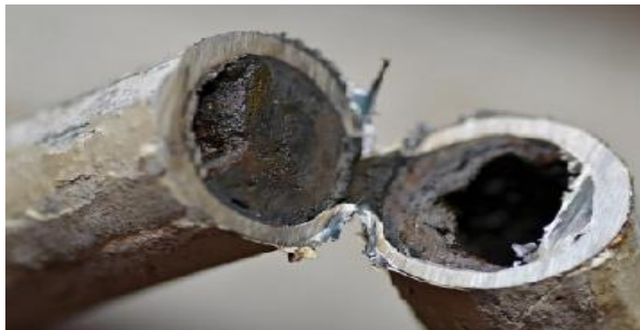
Рисунок 1. Загрязнение в трубе (стволе скважин)
