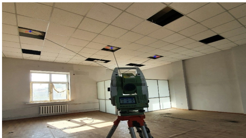
Рисунок 2– Геодезические измерения балок при помощи электронного тахеометра Швейцарской фирмы «Leica Geosystems» серии TC1201+
